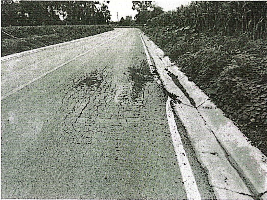
FOTO 02: DESLOCAMENTO LATERAL E REBAIXAMENTO DO REPARO FEITO PELA EMPRESA.
